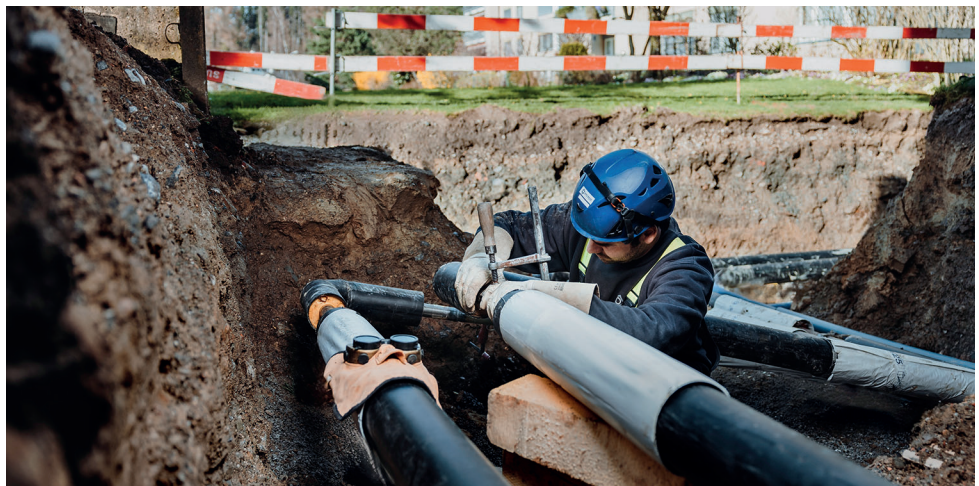
Bild: ewl energie wasser luzern
